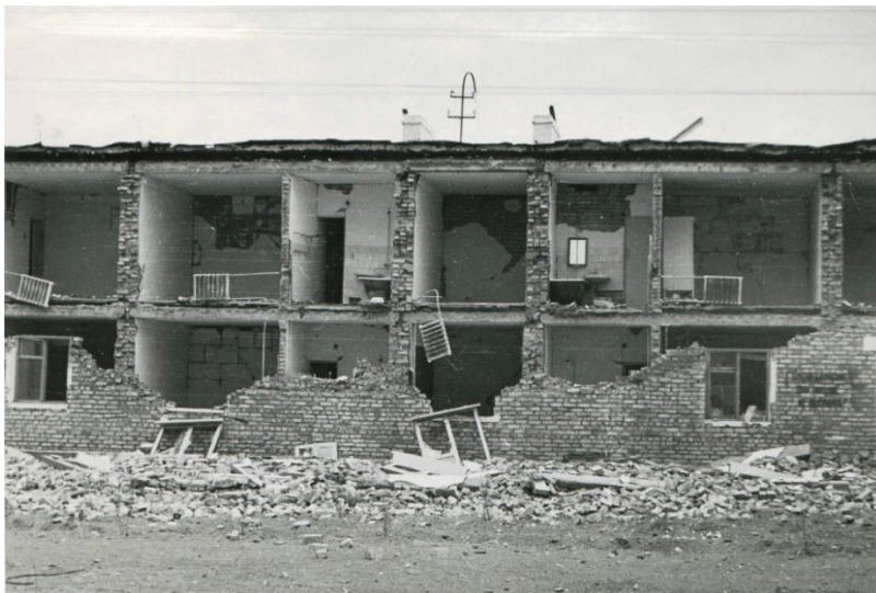
Рис. 2. Здание жилого дома №6 после землетрясения 08.04.1976г.
