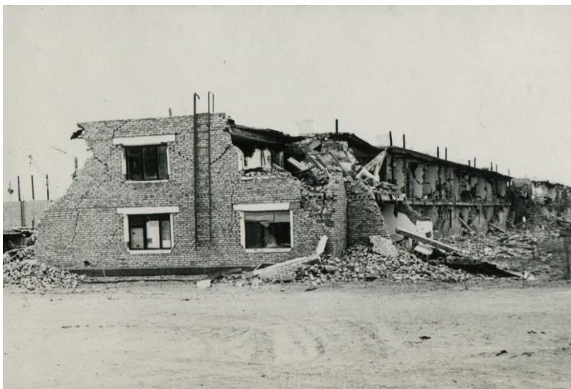
Рис.3. Здания жилых домов №№5; 6; и 7 после землетрясения 17.05.1976г.
